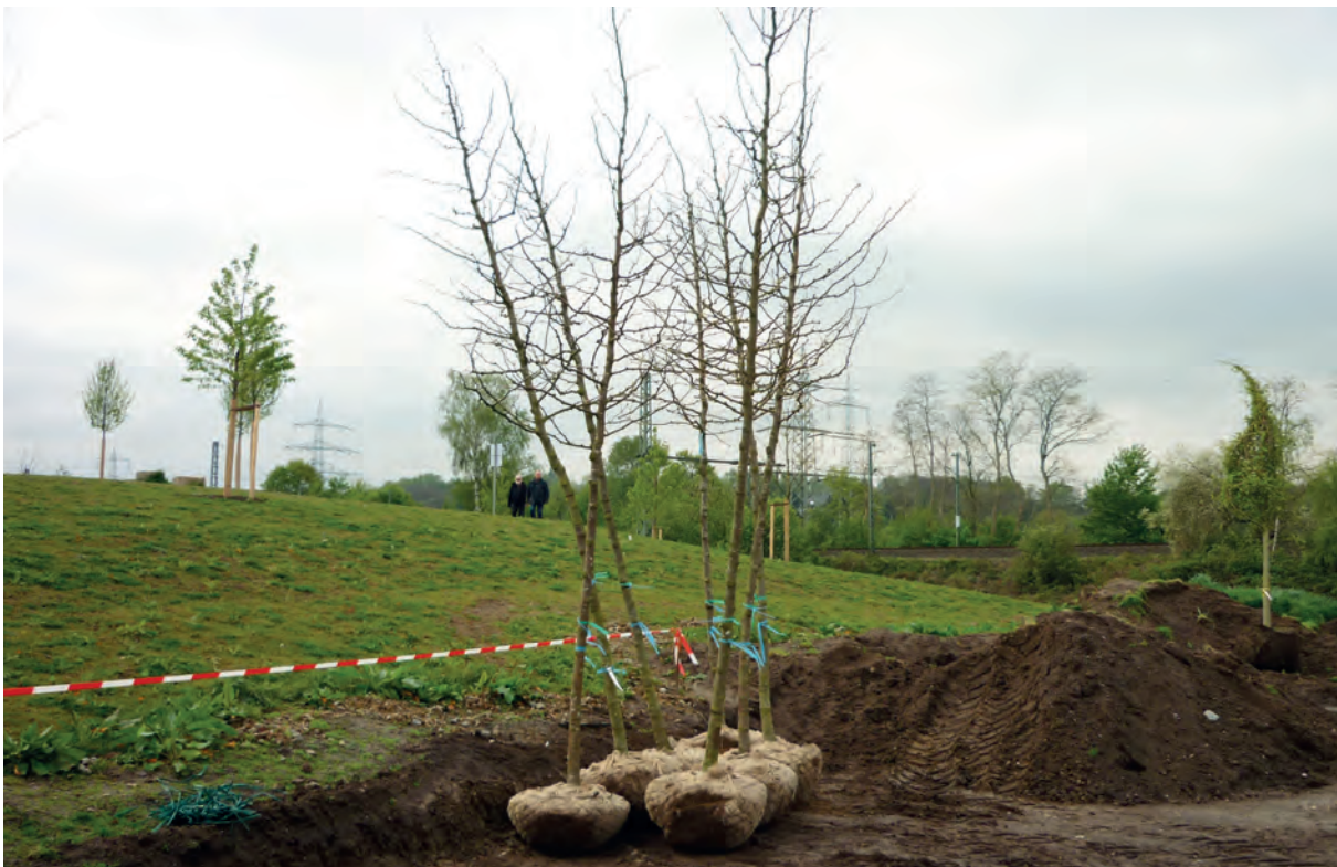
Abbildung 7: Jungbäume nach der Anlieferung auf die Baustelle und vor dem Bedecken der Wurzelballen mit Erdreich zum Schutz vor Austrocknung. Die hier zwischengelagerten Bäume haben bereits in der Baumschule einen Pflanzschnitt bekommen, damit Kronenvolumen und Wurzelmasse in einem ausgewogenen Verhältnis zueinanderstehen.
